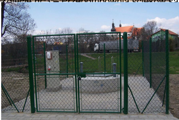
Zdjęcie nr 4 – Separator wód deszczowych wraz z osadnikiem przy ulicy Św. Ducha w Kłodawie.
